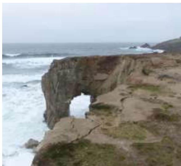
Des fragilités ont été constatées dans les falaises de plusieurs secteurs de la Côte Sauvage (ici près de l'arche de Port Blanc)
