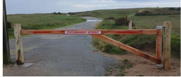
Barrière cassée et remplacée à Port-Rhu, Saint-Pierre-Quiberon
