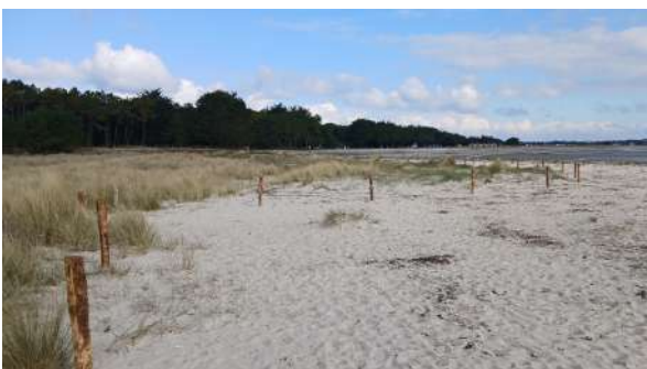
Reprise des clôtures de front de mer suite aux tempêtes aux Sables Blancs, Plouharnel
